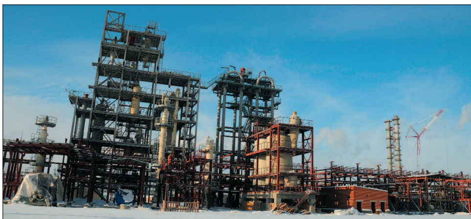
На заводе по производству полипропилена группы компаний «Титан» (Омск) завершается монтаж оборудования
